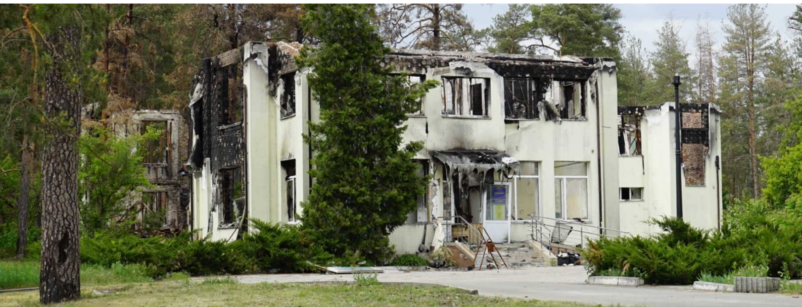
Зруйнована будівля у місті Святогірськ, Донецька область
