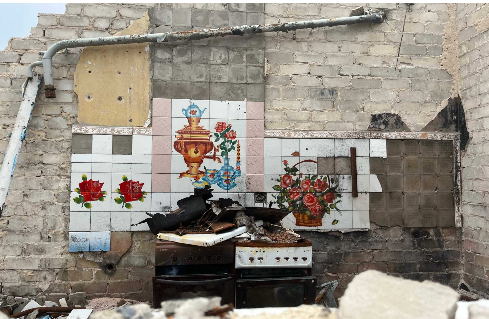
Знищений будинок у селі Кам'янка, Харківська область
