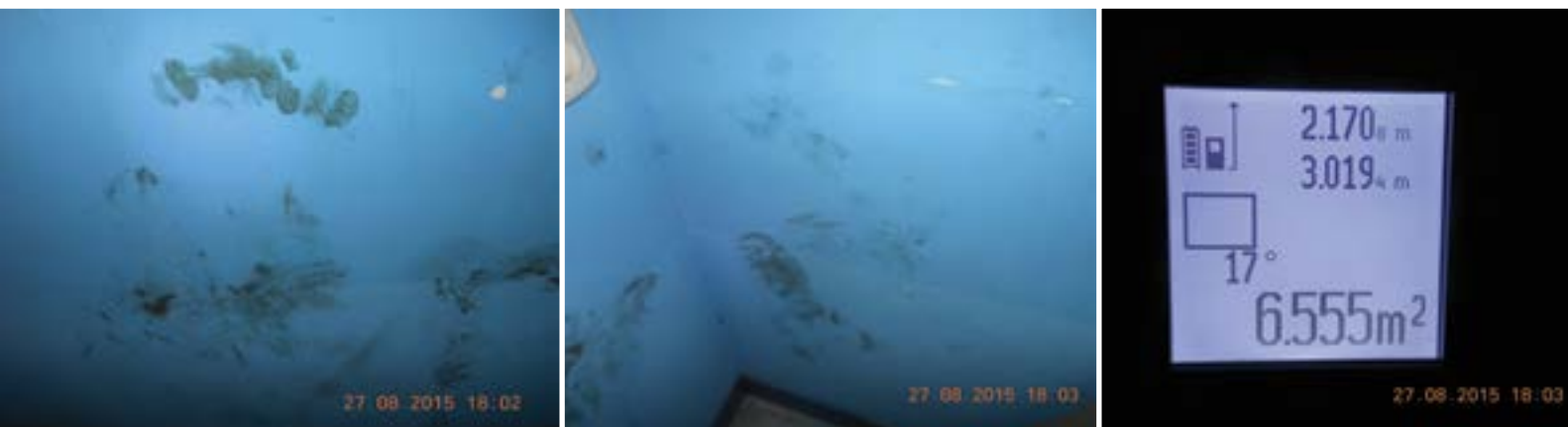
Фото 45-47. Умови утримання та сліди крові на стінах у підвальному приміщенні, що використовувалося як незаконне місце позбавлення волі проросійськими озброєними формуваннями. Приватний будинок, м. Слов'янськ, вул. Розі Люксембург, 53.
